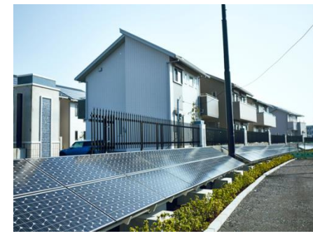
⑨県道沿いに400mのソーラー。(災害時にも電源を安定供給)
